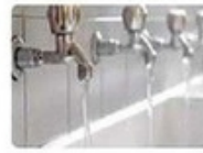
İçme suyu sistemleri
